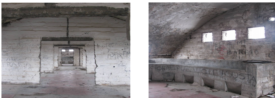
Figuras 6. Izq. Interior pabellón de obreros. Der. Zona de aseo. Ruinas del ex campamento obrero-militar Embalse el Yeso. (Fotografías de la autora).
